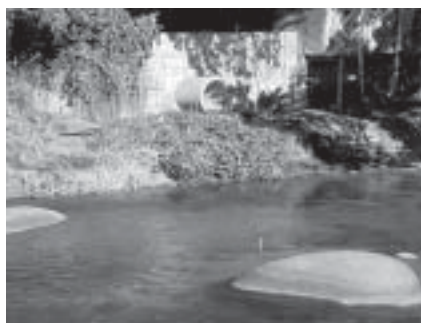
Lançamento de esgoto em rio Município de Cachoeiras de Macacu 2004
