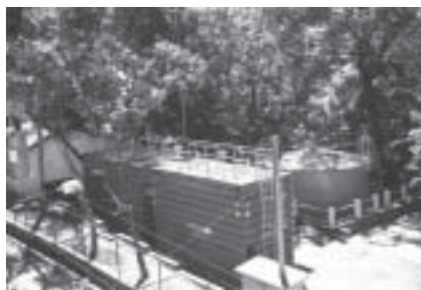
Estação de Tratamento de Água Município de Guapimirim 2004
